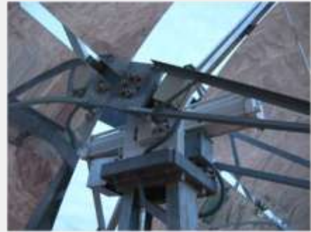
Fig. 1 Sistema de seguimiento electrohidráulico
