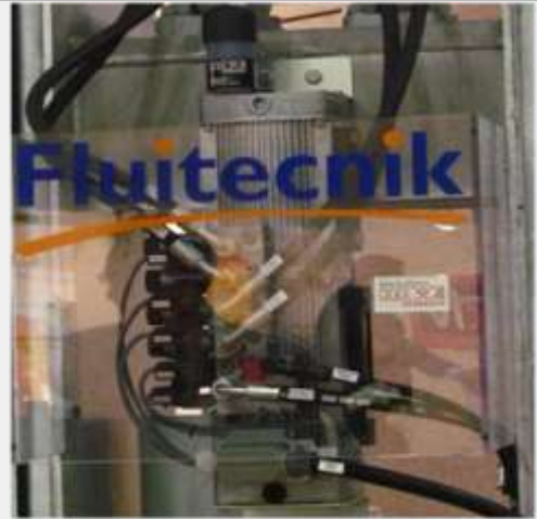
Fig.5 Válvulas del sistema hidráulico de seguimiento de la firma FLUITECNİK HAWE
